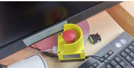
控制室内急停按钮
