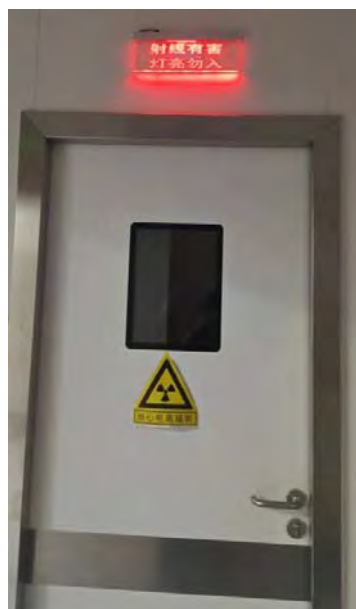
污物门外设置的放射性标志、中文警示说明和“射线有害 灯亮勿入”工作状态灯箱
